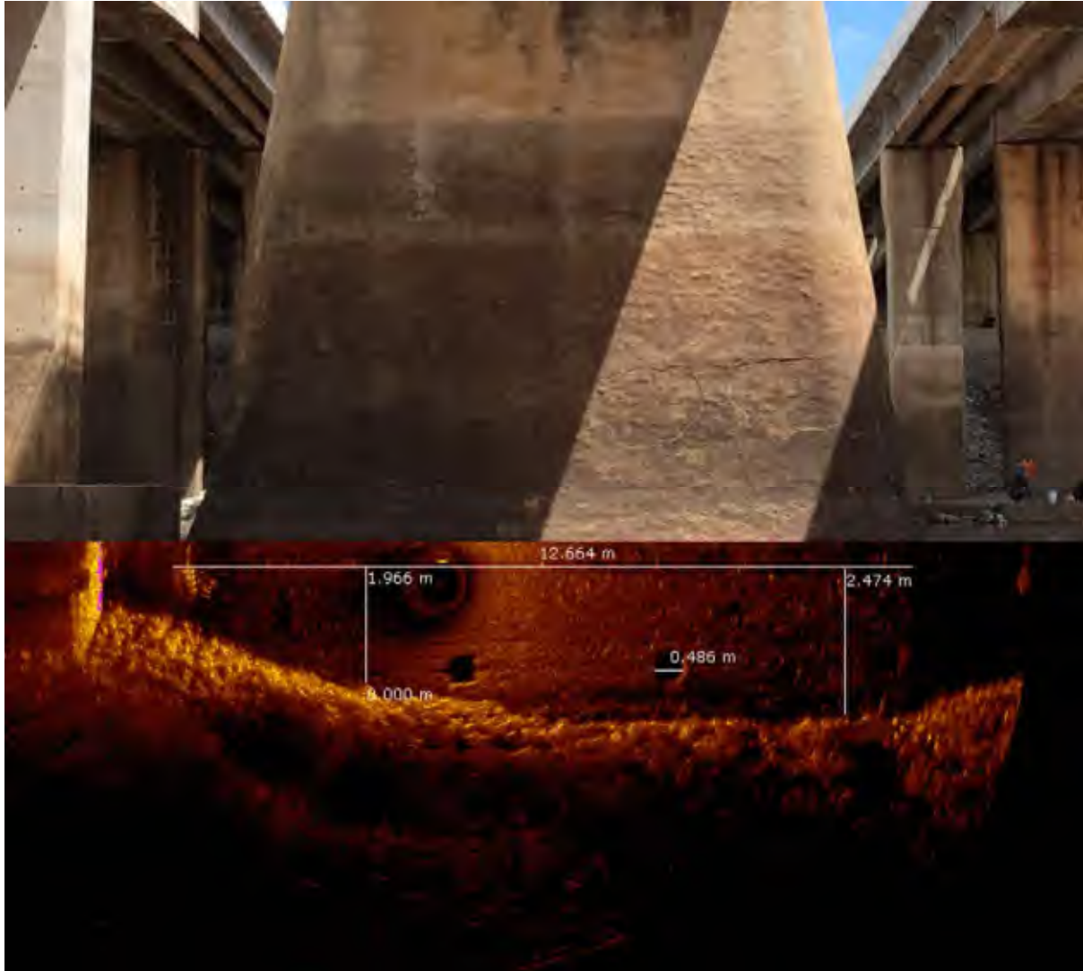
รูปที่ 4-24 ผลการสำรวจการกัดเซาะของดินบริเวณตอม่อ P7 (MT) ด้านกรุงเทพฯ
