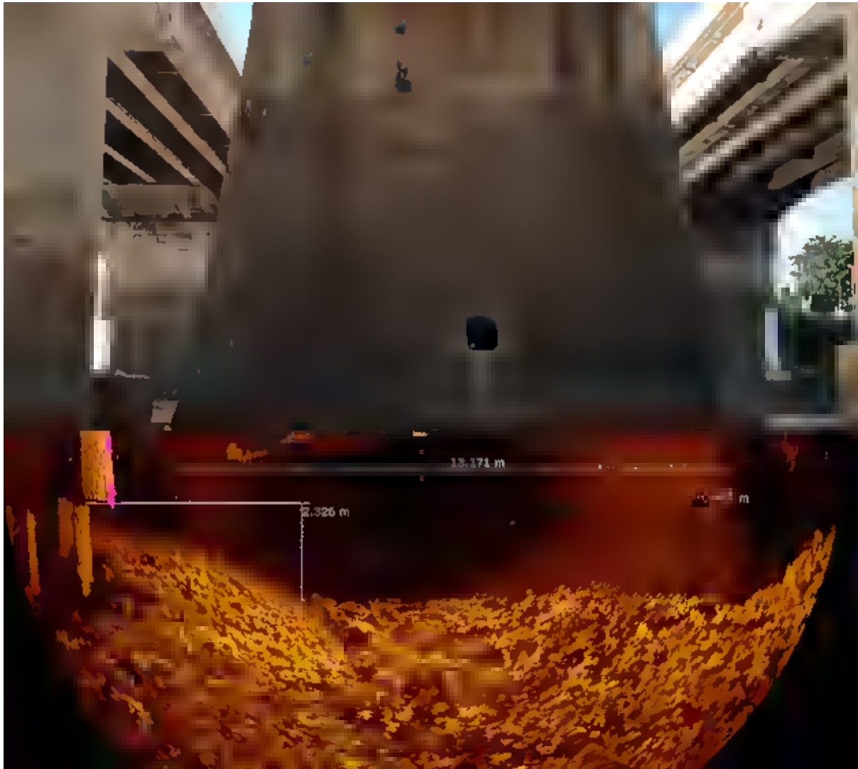
รูปที่ 4-19 ผลการสำรวจการกัดเซาะของดินบริเวณตอม่อ P6 (MT) ด้านกรุงเทพฯ
