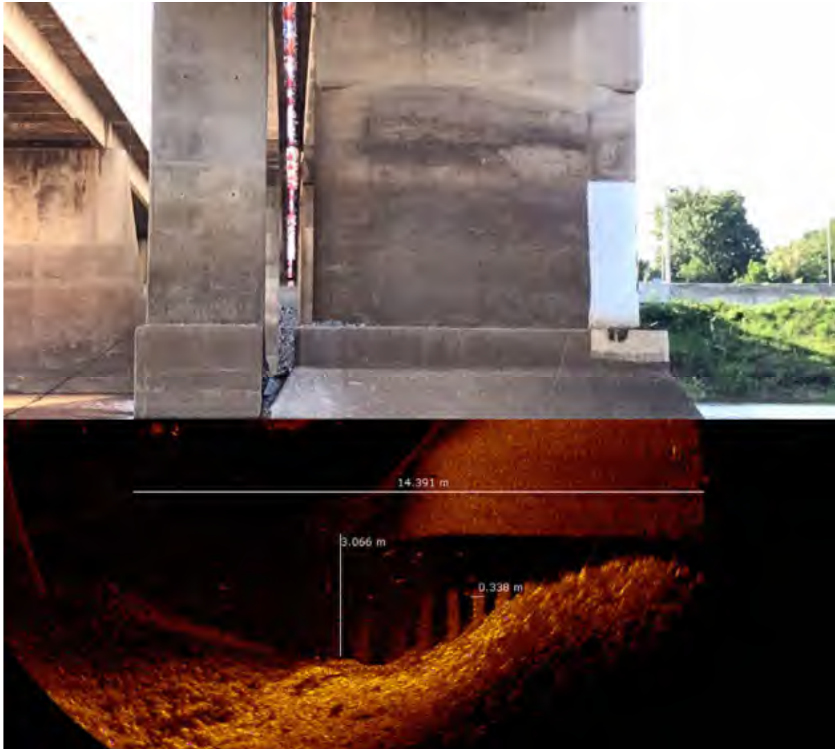
รูปที่ 4-21 ผลการสำรวจการกัดเซาะของดินบริเวณตอม่อ P6 (RT) ด้านกรุงเทพฯ
